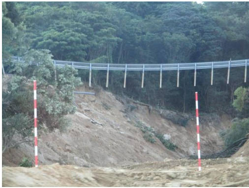
広島呉道路崩落の様子
