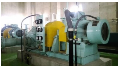
ゆめが丘浄水場 高効率ポンプ
