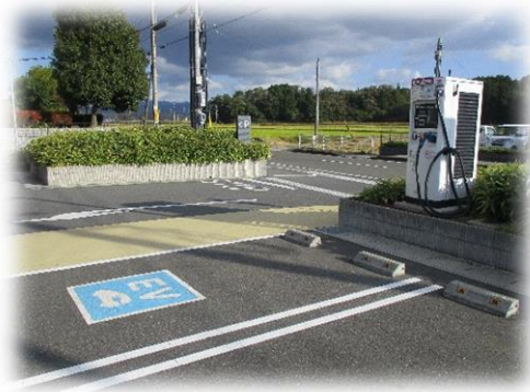
伊賀市役所 電気自動車急速充電器
