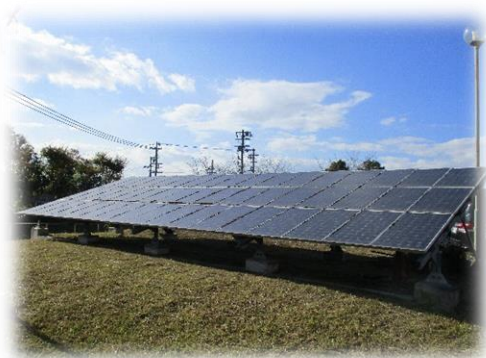
さくらりサイクルセンター 太陽光発電設備
