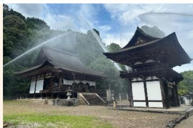
7 重要文化財防災設備保守点検事業 (観音提寺本堂・楼門、大村神社宝殿)
