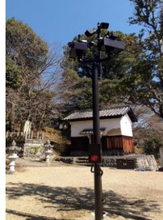
防火施設設置状況
