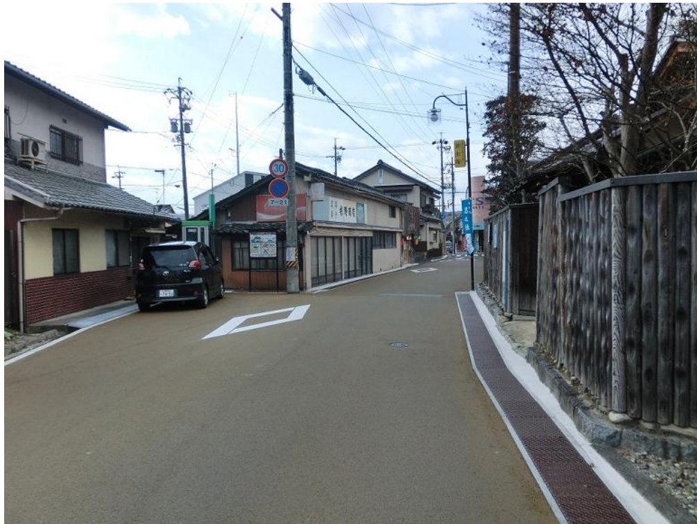
No.2+10.50 付近: 脱色アスファルト
