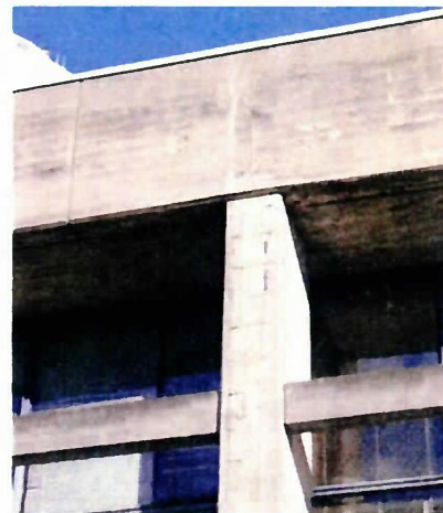
コンクリートの剥落
