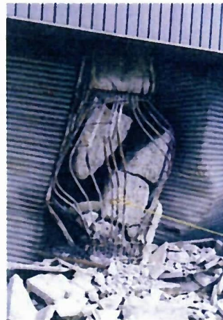
柱のせん断破壊
