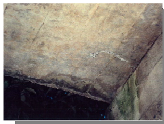
①方向性のひびわれの発生
