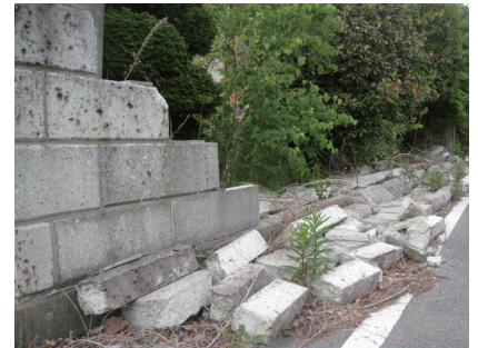
地震により石塀が倒壊
