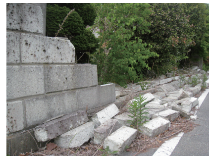
地震により石塀が倒壊
