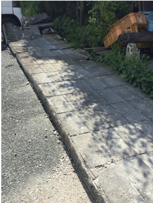
地震によりブロック塀が倒壊
