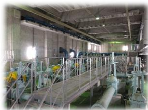
送水ポンプ棟照明
