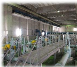
送水ポンプ棟照明
