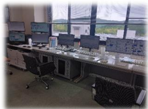
浄水場中央監視室
