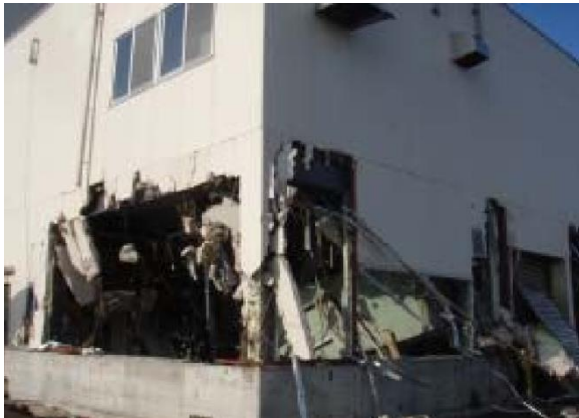
地震による建物の被害
