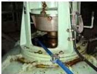
ポンプ本体(内部軸受)の劣化
