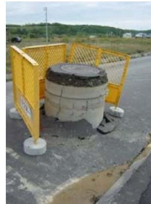
液状化現象によるマンホール突出
