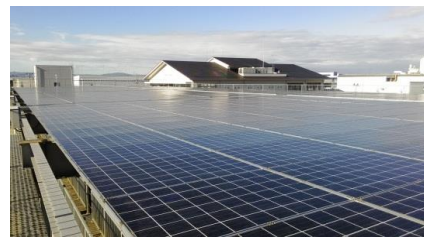
ゆめが丘浄水場 太陽光発電
