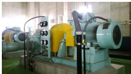
ゆめが丘浄水場 高効率ポンプ
