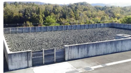
ゆめが丘浄水場 天日乾燥床
