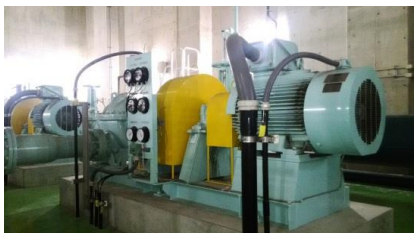
ゆめが丘浄水場 高効率ポンプ
