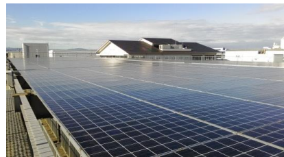
ゆめが丘浄水場 太陽光発電
