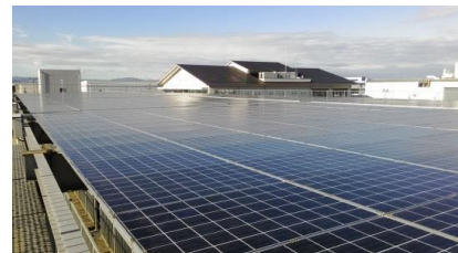
ゆめが丘浄水場 太陽光発電
