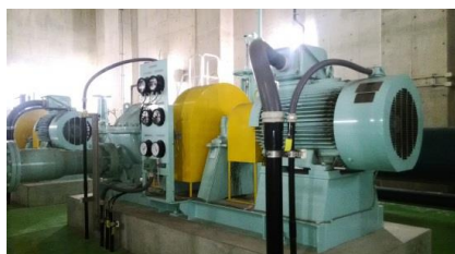
ゆめが丘浄水場 高効率ポンプ
