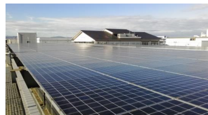
ゆめが丘浄水場 太陽光発電
