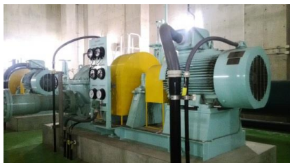
ゆめが丘浄水場 高効率ポンプ
