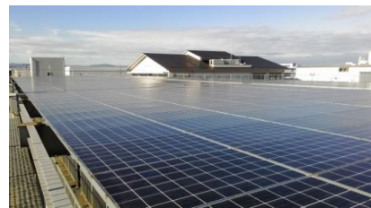
ゆめが丘浄水場 太陽光発電
