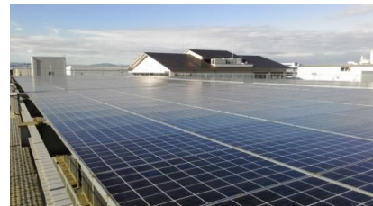
ゆめが丘浄水場 太陽光発電
