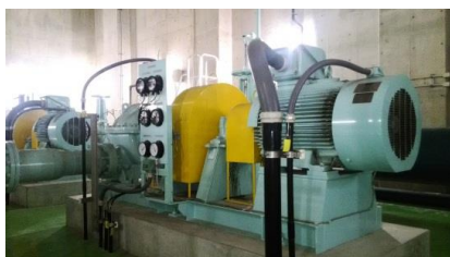
ゆめが丘浄水場 高効率ポンプ
