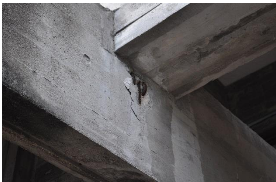
正面玄関上部 コンクリート剥離状況
