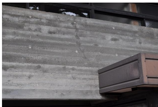
東側中 2 階ベランダ外面クラック
