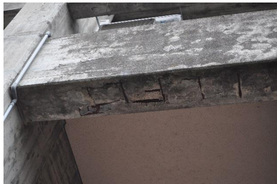
東側 2 階ベランダ下面鉄筋露出状況
