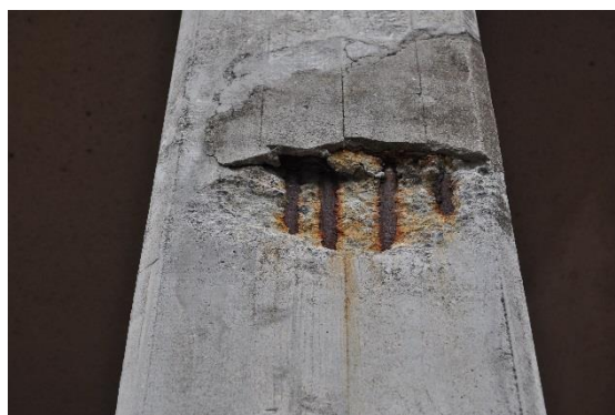
東側外柱 コンクリート剥離状況
