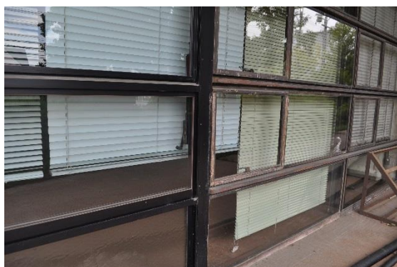
1 階東側 水平連続窓 劣化状況
