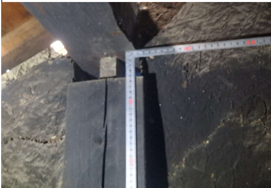
木部状況 北側柱、棟より 50mm外れ
