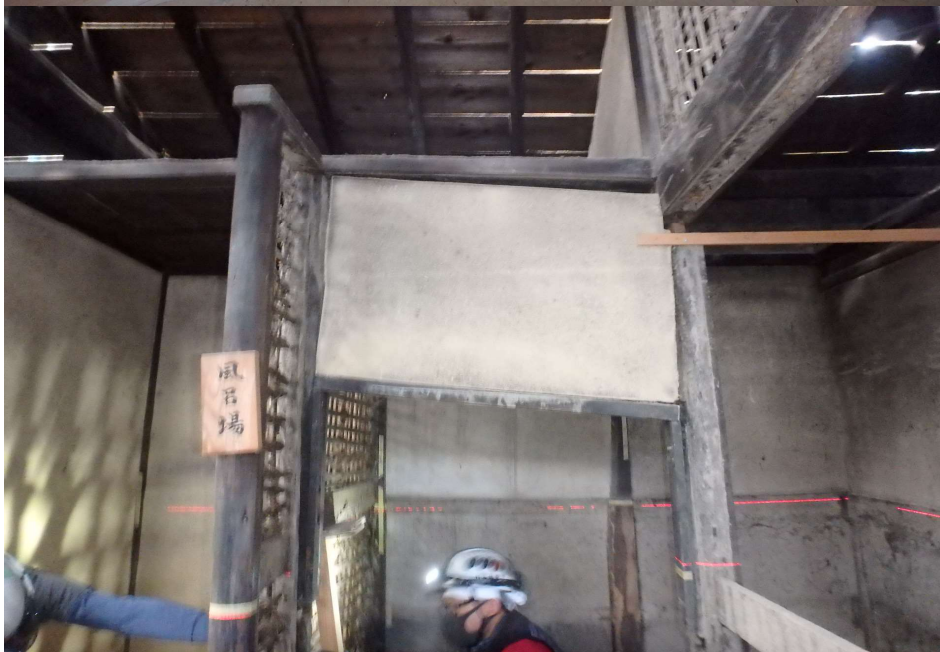
土壁状況 風呂上部 建起しによる小舞外れ
