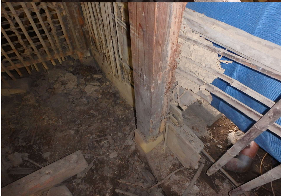
木部状況 北側柱 腐朽状況
