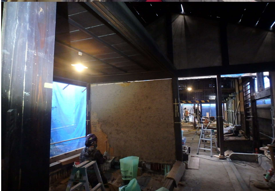
土壁状況 三帖東側 建起しによる小舞外れ
