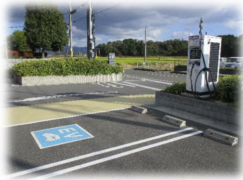
伊賀市役所 電気自動車急速充電器
