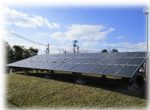
さくらリサイクルセンター 太陽光発電設備
