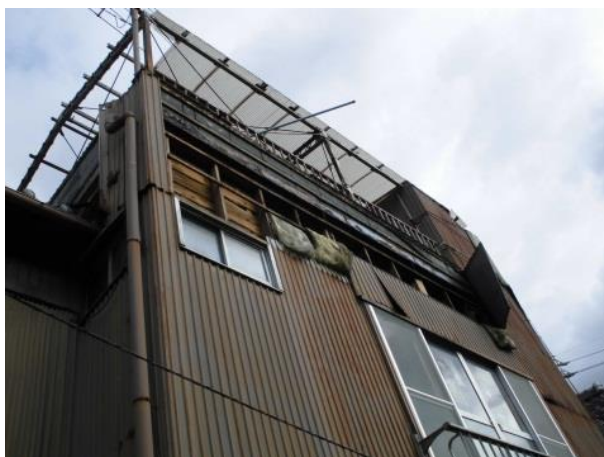
西側外壁仕上げ材剥離状況
