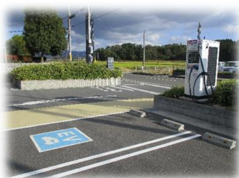
伊賀市役所 電気自動車急速充電器
