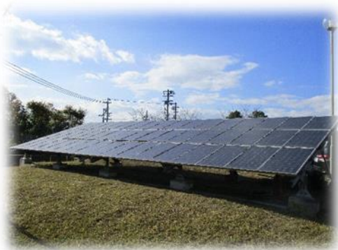
伊賀市さくらリサイクルセンター 太陽光発電設備
