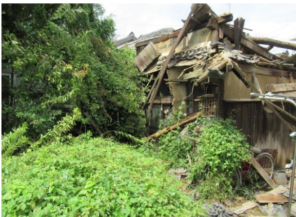
建物倒壊状況
