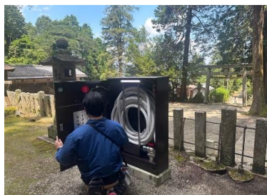
防災設備点検 猪田神社（猪田）
