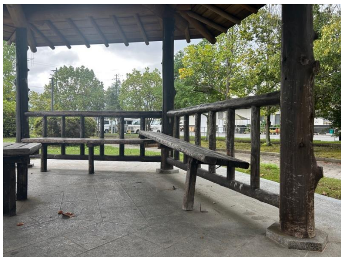
ベンチ破壊状況
