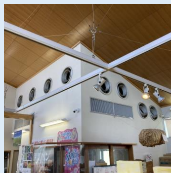
空調設備吹き出し口
