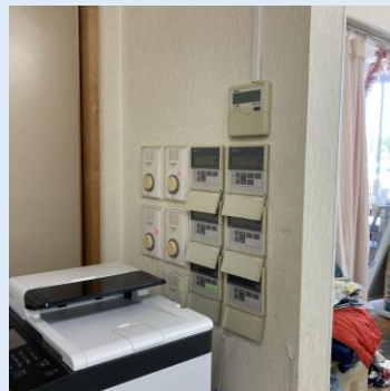
空調設備操作パネル
