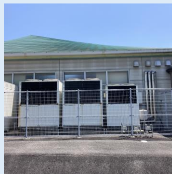
空調設備室外機
