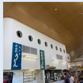
空調設備吹き出し口
