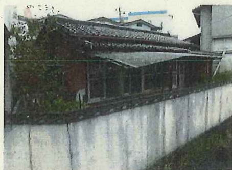
敷地外への樹木の繁茂 屋根材の落下のおそれ
