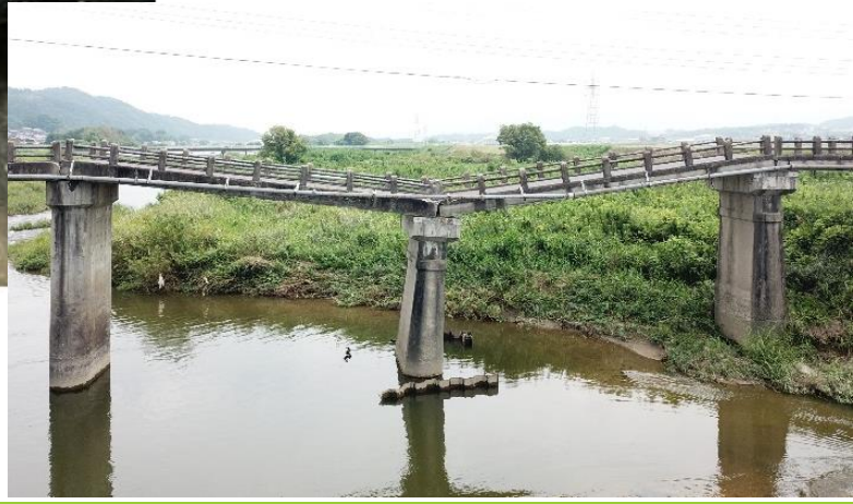
架橋後、65年が経過し落橋した橋梁
