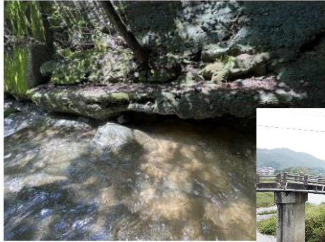
基礎の洗堀(80年経過)
