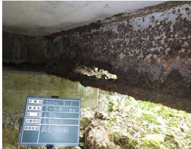
鋼桁の腐食・破断(60年経過)
