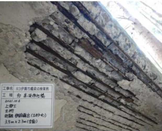
鉄筋コンクリート桁の劣化(60年経過)
