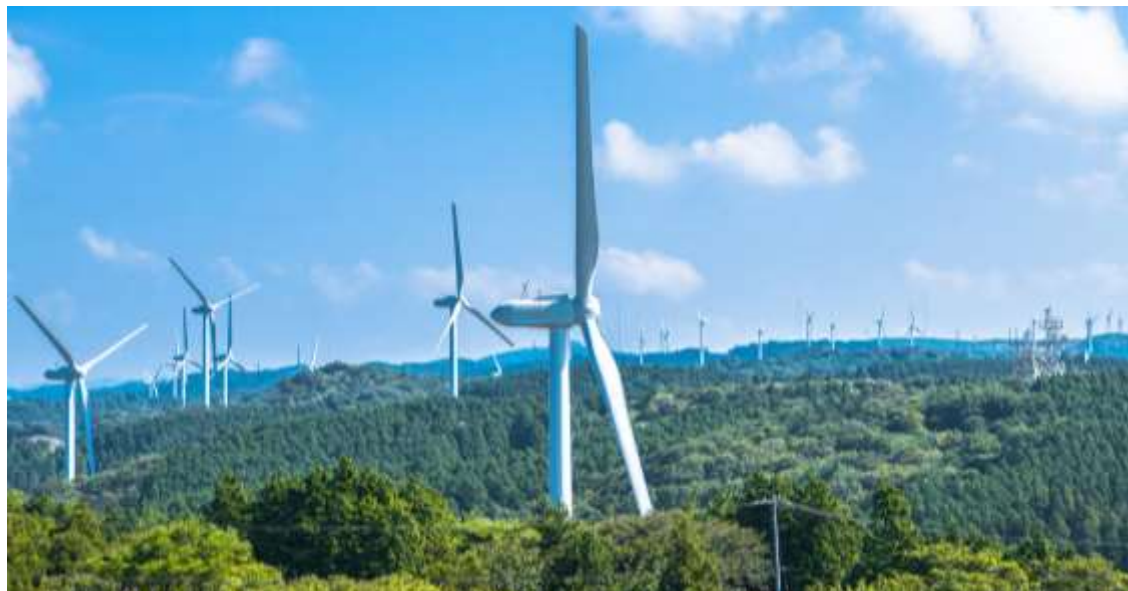
図20 青山高原の風力発電設備 (出典：青山高原ウインドファーム)
