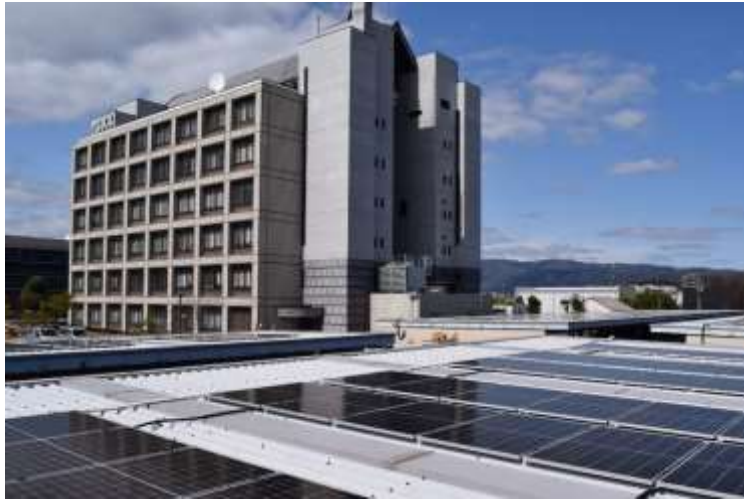
図10 三重県伊賀庁舎の太陽光発電設備
