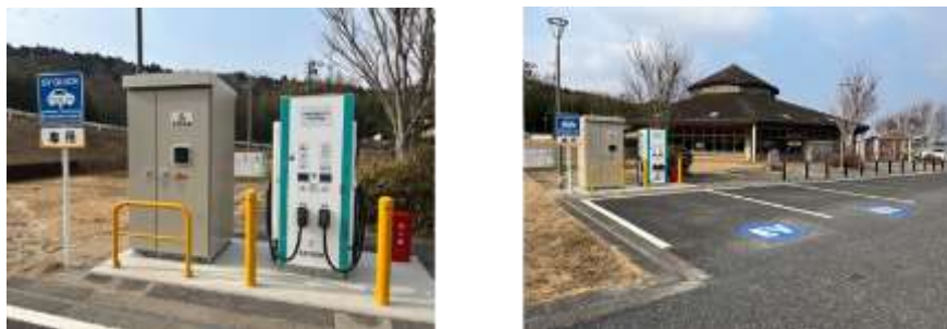
図62 道の駅いがにおける電気自動車用急速充電器 (出典：伊賀市HP)
