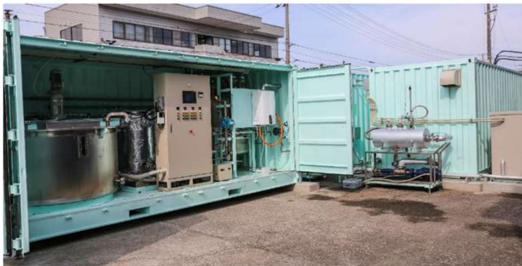
図 超小型バイオガスプラント
