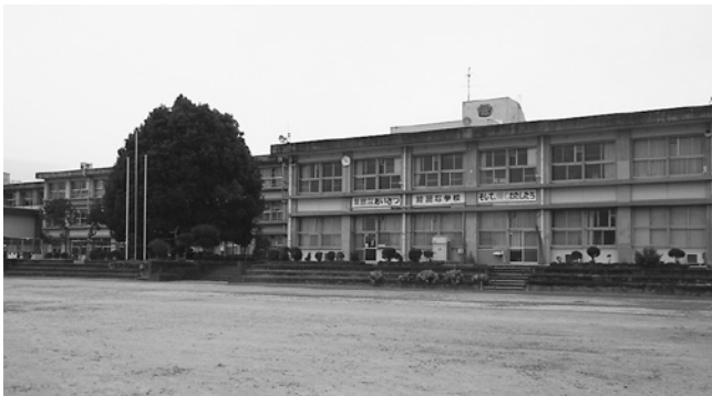
来年4月からのいがまち地区中学校統合に向けて改修等が行われる現在の霊峰中学校校舎
